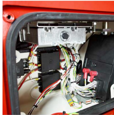
Электрический шкаф легко доступен.
